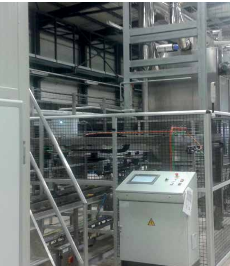
Auslauf aus dem Garraum, die Schneidmaschine vor dem Backofen, der Durchlaufbackofen und die Abkühlstrecke vor dem Schockfroster in der griechischen Anlage © JhD-Dienstleistungen
